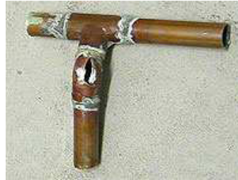
Frostschäden an Wasserleitungen
